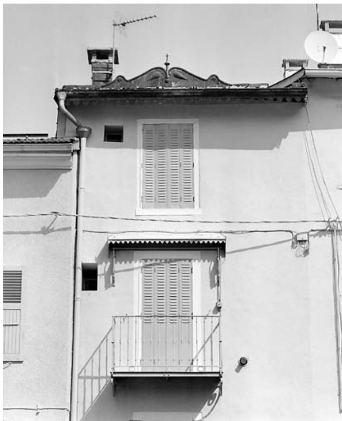
Maison avec atelier (19e siècle) au n° 3 rue Raspail : balcon et couronnement métallique. Maison (AE 68 et 69). 39, Morez
