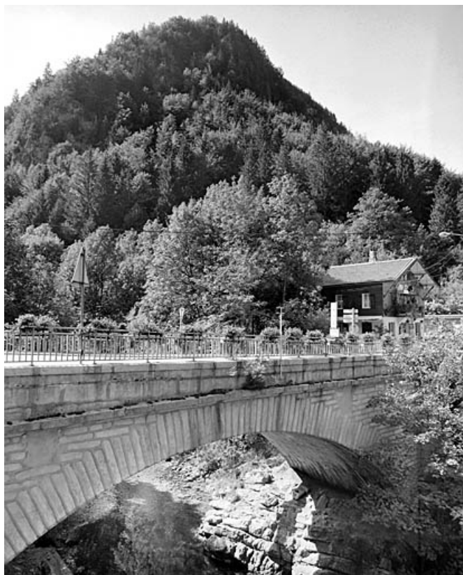
Pont des Douanes : vue de trois quarts, depuis la rive gauche en aval. 39, Morez
