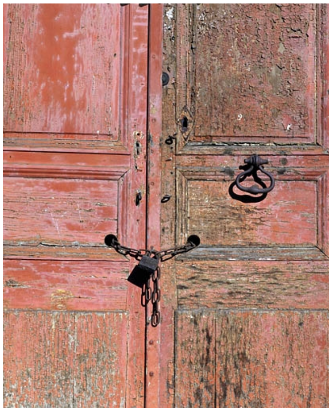
Entrée principale : détail des vantaux.
