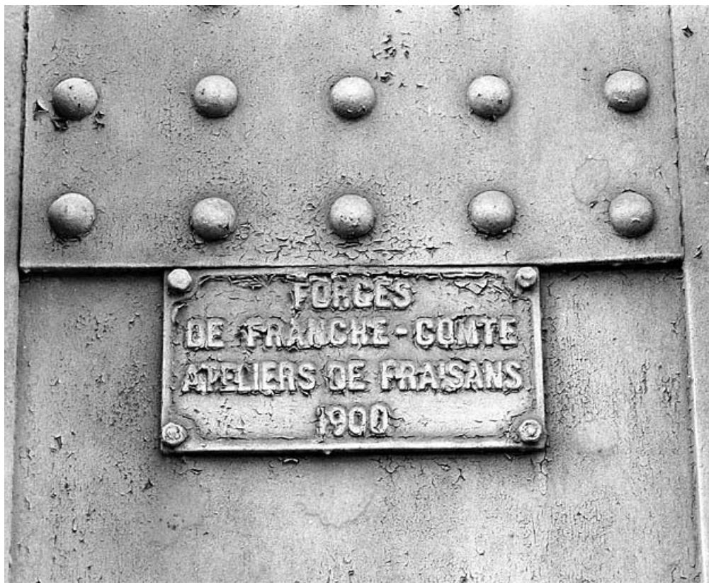
Plaque du constructeur et date. Cette plaque est fixée sur le pont, côté La Cluse. 39, Chassal, lieudit : en Risoux
