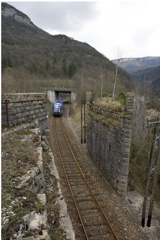
Pont du tacot et pont routier, depuis le côté La Cluse (ouest), avec autorail X 73500. 39, Lavans-lès-Saint-Claude R.D. 470, lieudit : Lizon
