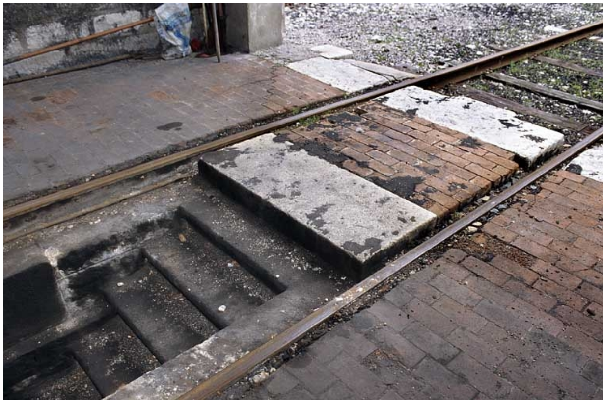
Remise ferroviaire : escalier d'accès à la fosse dans la halle est. 39, Saint-Claude place de la Gare
