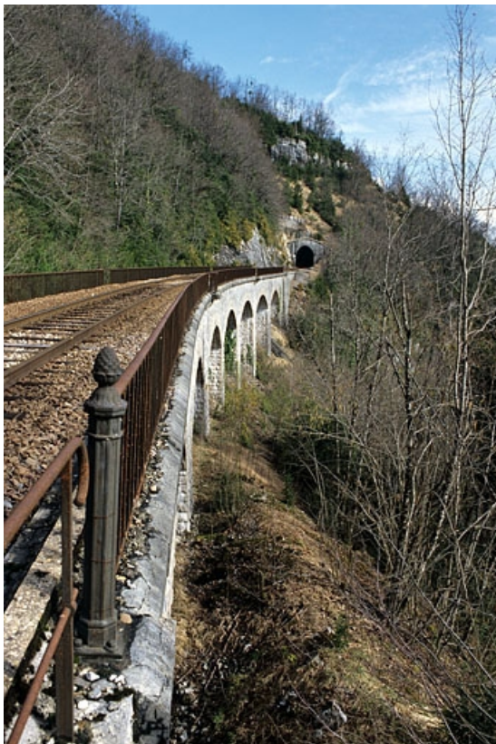
Viaduc de la Grande Roche et tunnel du Crapaud : vue d'ensemble, depuis le côté La Cluse (sud). 39, Saint-Claude, lieudit : sous la Roche
