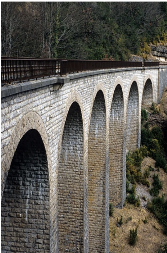
Viaduc : piles de l'élévation aval, vues en enfilade depuis le côté La Cluse.
