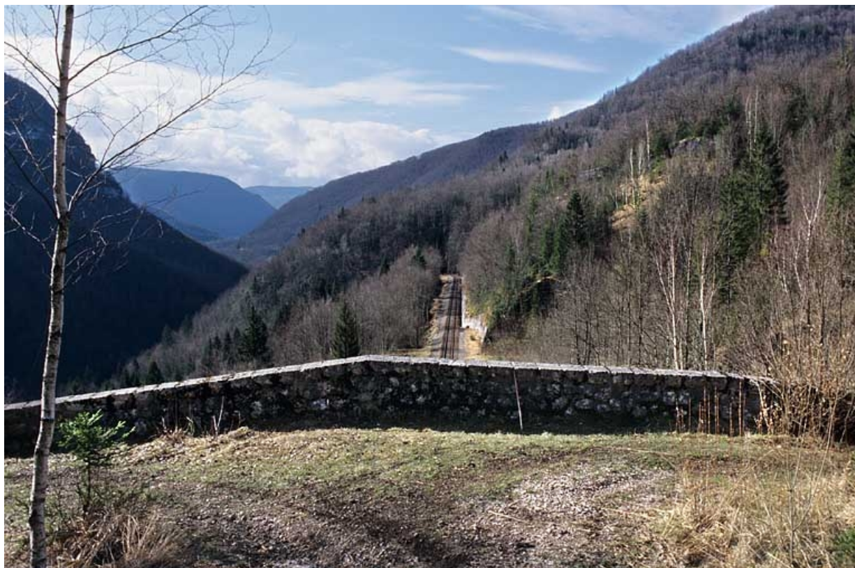
Tunnel : mur de protection de la tête côté La Cluse, depuis le chemin qui la surmonte, avec vue sur la vallée de la Bienne. 39, Saint-Claude chemin de la Gare, lieudit : Valfin-lès-Saint-Claude
