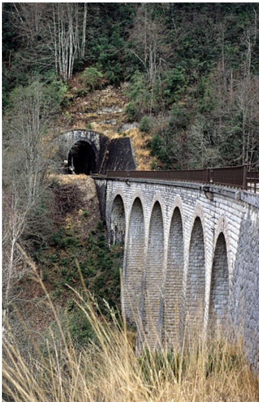
Viaduc : élévation aval, vue en enfilade depuis le côté Andelot-en-Montagne. 39, Saint-Claude chemin de la Gare, lieudit : Valfin-lès-Saint-Claude
