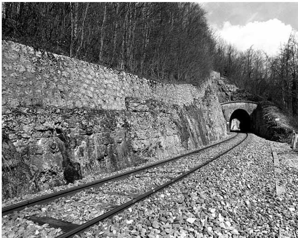
Tunnel de Tancua : vue d'ensemble, côté La Cluse (sud). 65, Tancua, lieudit : la Côte
