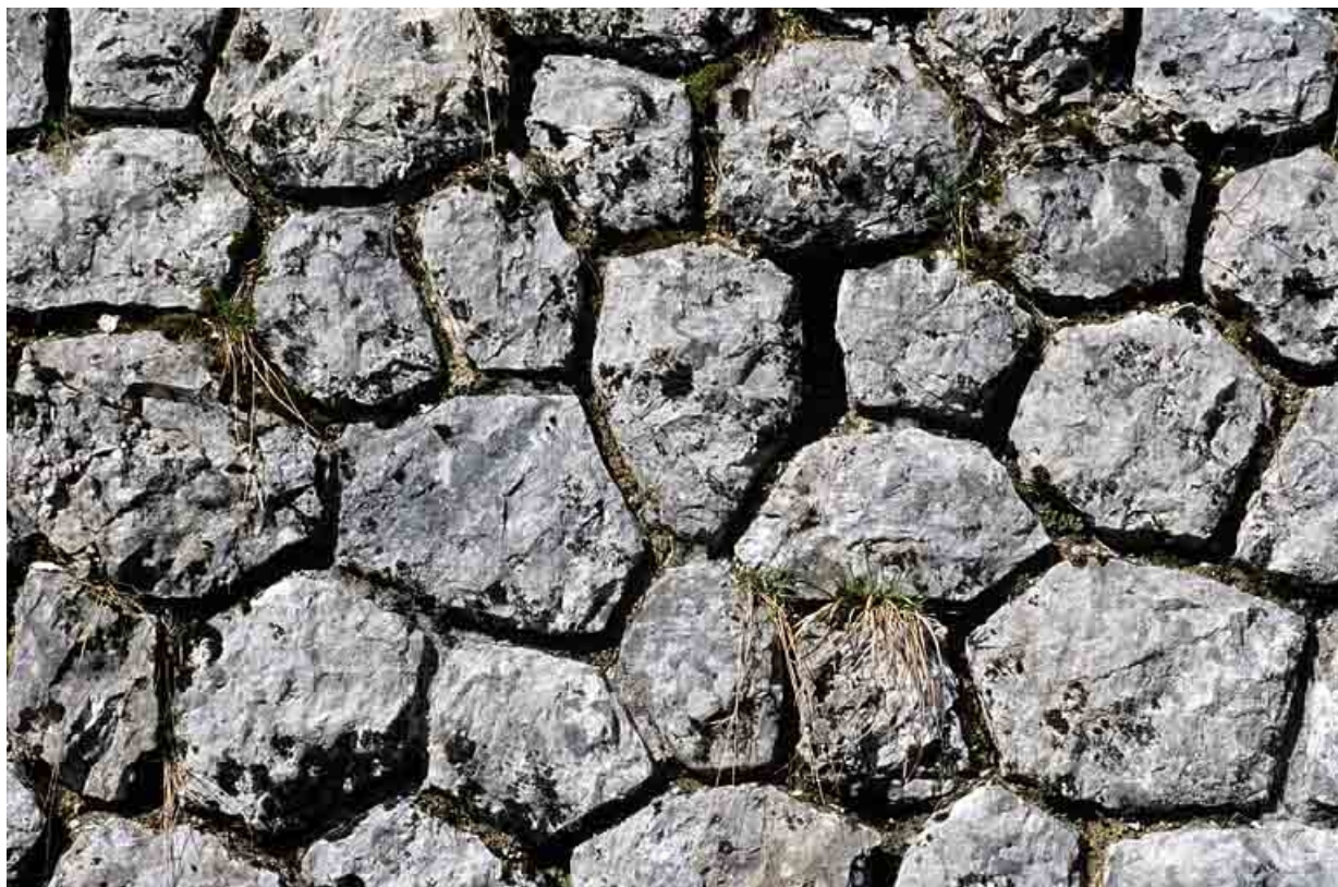
Tunnel du Chalet : détail de l'appareil du mur en aile, côté La Cluse.
