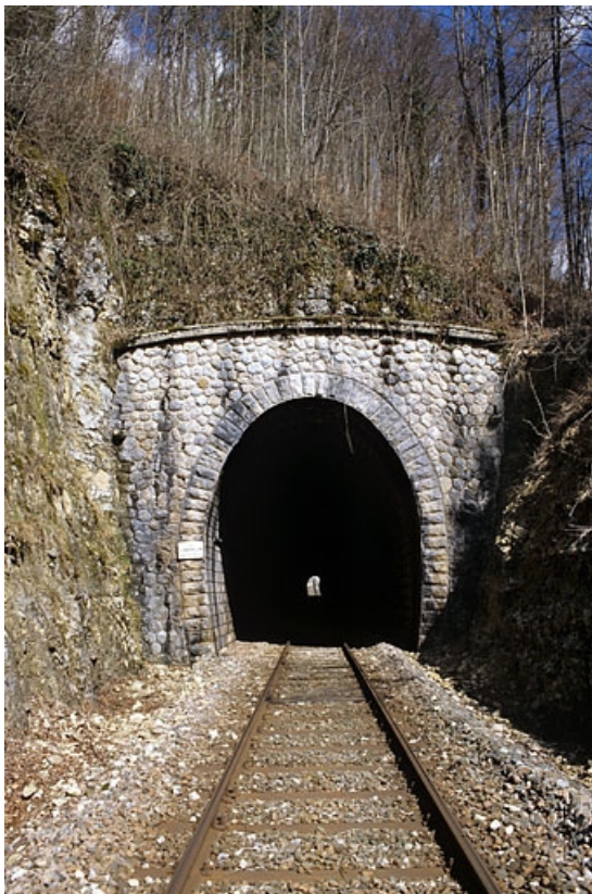
Tunnel du Grépillon : tête côté La Cluse (sud). 39, Morbier, lieudit : la Côte
