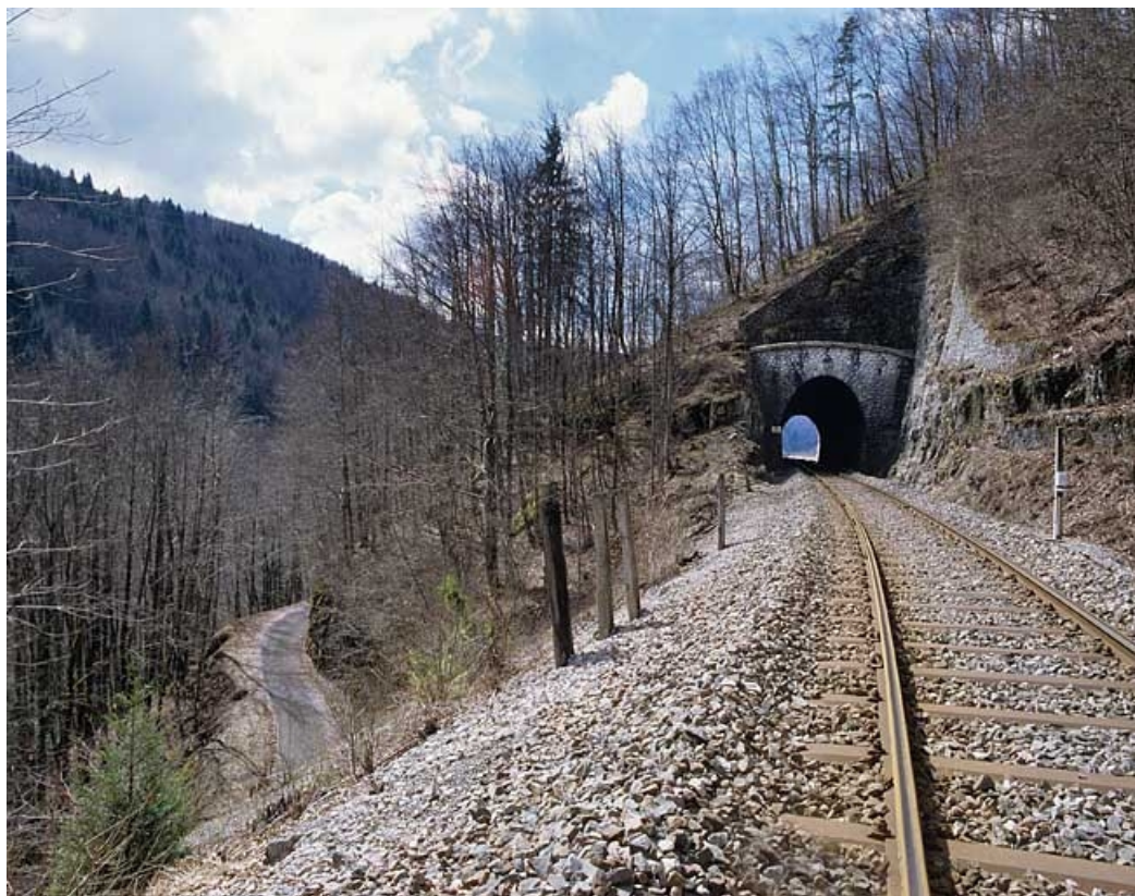
Tunnel de Tancua : vue d'ensemble, côté Andelot-en-Montagne (nord). 65, Tancua, lieudit : la Côte
