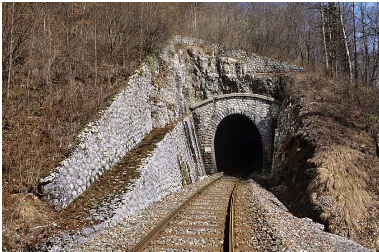
Tunnel du Chalet : vue d'ensemble, côté La Cluse (sud). À gauche, mur en aile sur deux niveaux. 39, Morbier, lieudit : la Côte
