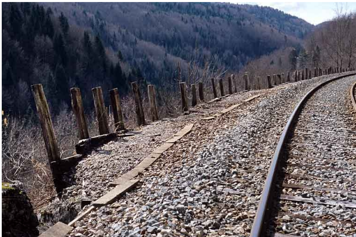
Traverses placées en soutènement de la voie côté La Cluse (sud), à la sortie du tunnel de Tancua (vers le PK 053.000).
