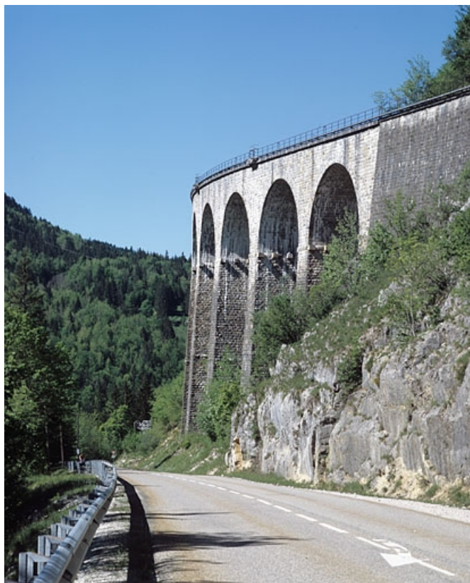
Vue de profil depuis la route départementale n° 18, au nord-est. 39, Morbier, lieudit : le Bois des Crottes
