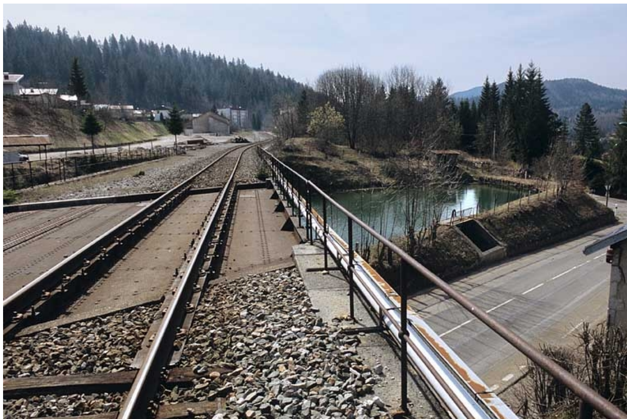
Pont et viaduc : tablier depuis la voie côté Andelot-en-Montagne, avec bassin de retenue Gaudard. 39, Morbier route Blanche
