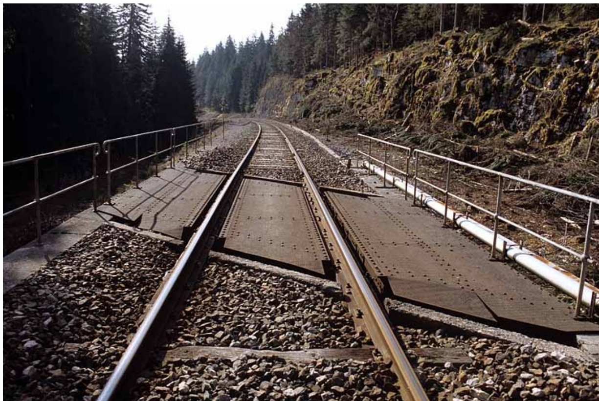
Tablier métallique, depuis la voie côté Andelot-en-Montagne. 39, Saint-Laurent-en-Grandvaux, lieudit : la Forêt de la Joux devant
