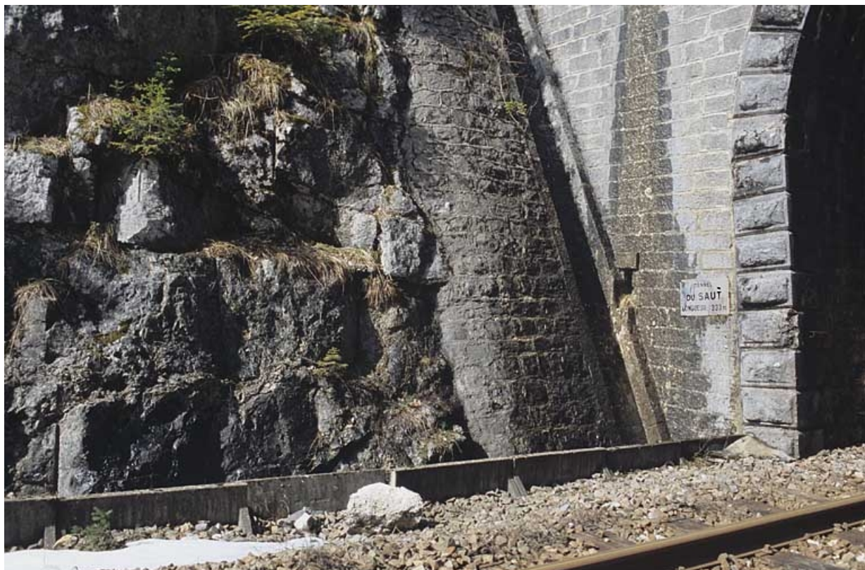
Tête côté La Cluse : descente d'eau, chantepleure et caniveau (détail). 39, La Chaumusse, lieudit : la Vie de la Serre
