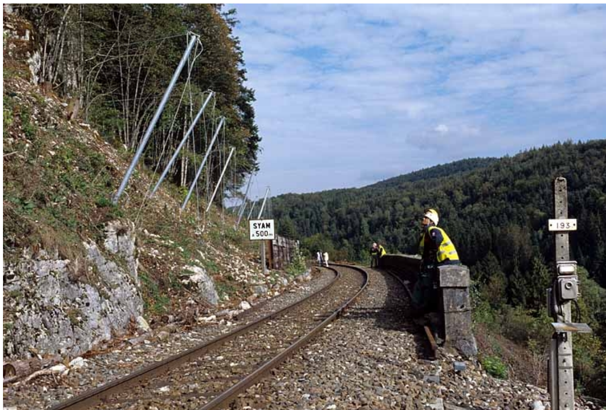
Sécurisation de paroi rocheuse à Syam : système d'ancrage des filets de protection près de la voie.
