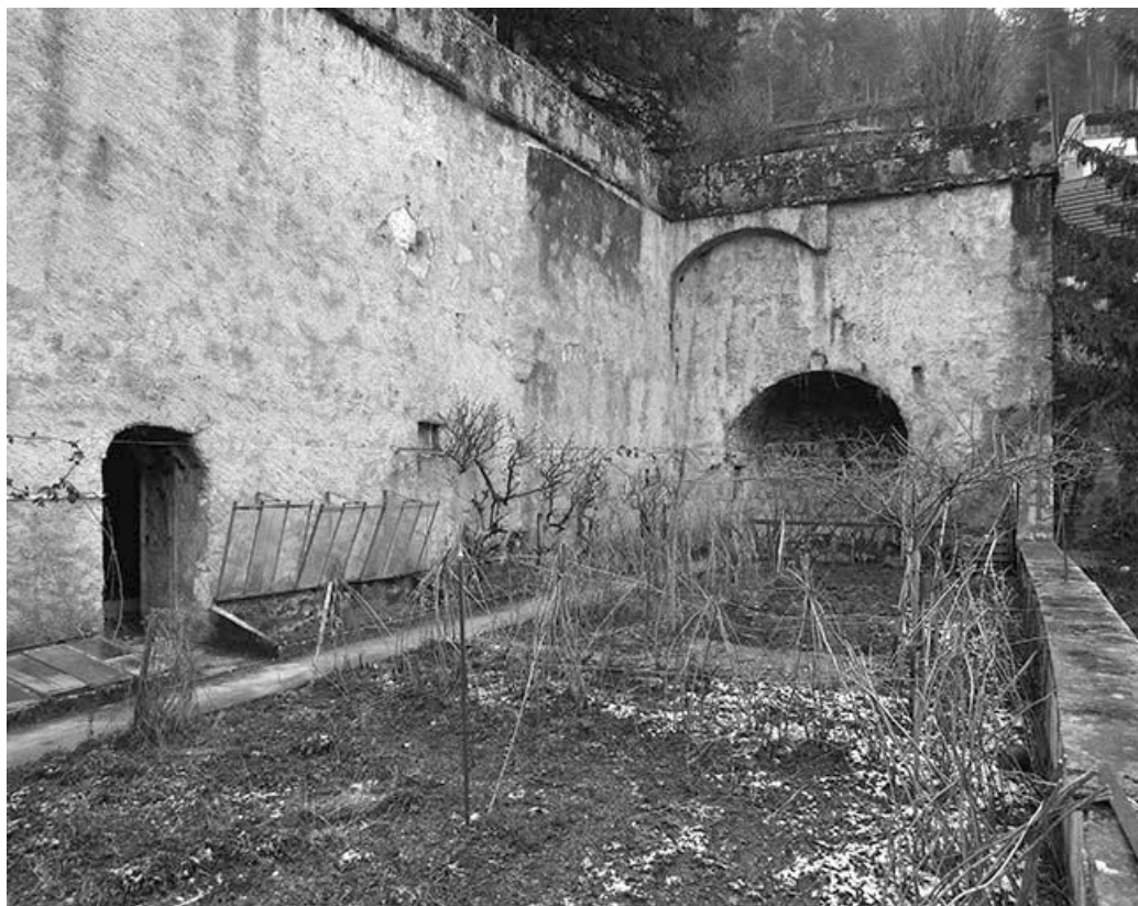
Mur de soubassement du jardin vu de trois quarts et abside de la chapelle Saint-Sébastien. 39, Saint-Claude, 2 rue de la Sous-préfecture
