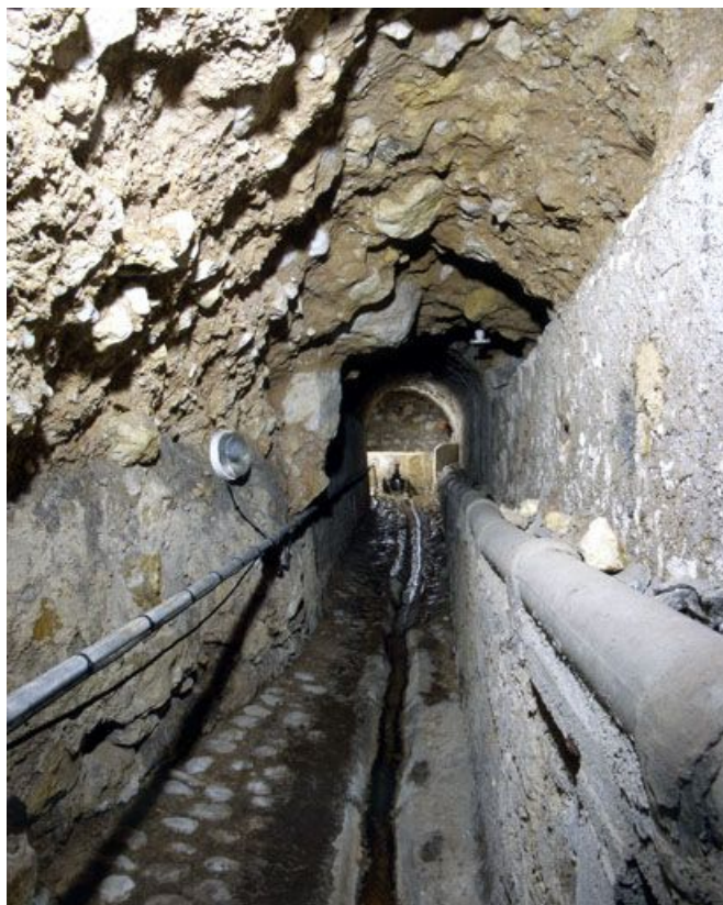
Conduit hydraulique des infirmeries, vue de la source depuis le centre du conduit.
