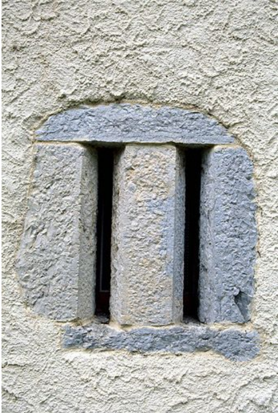
Baie fromagère de la fromagerie des Mandrillons, à Bellefontaine.
