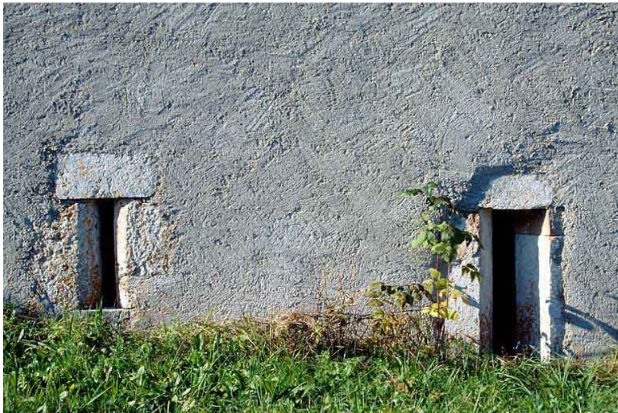
Baies fromagères de la fromagerie des Raisses, à Longchaumois.
