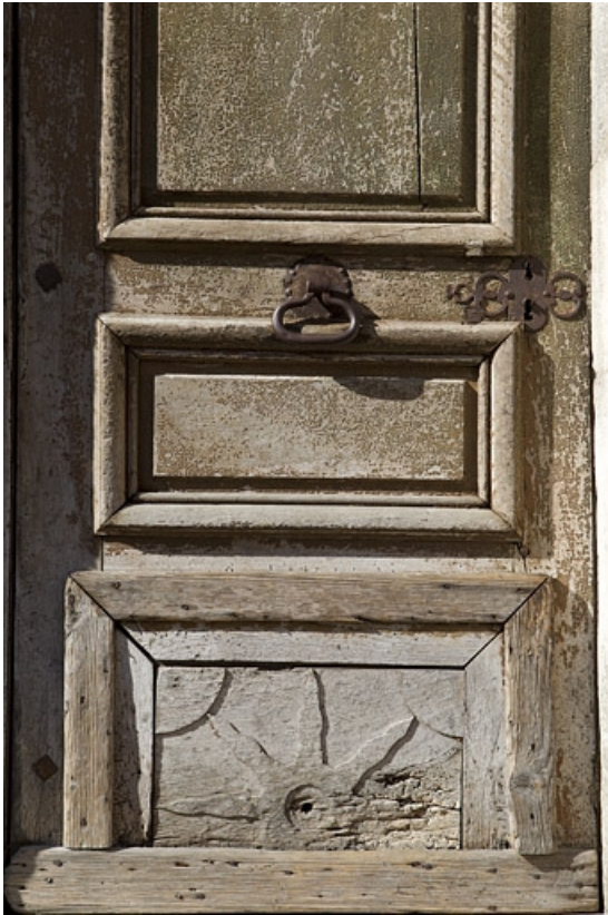
Porte principale sur la rue Merlin : détail du vantail. 39, Morez, 4, 6 rue Ernest Merlin
