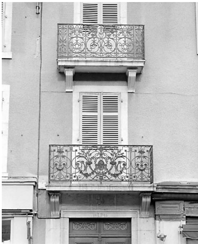
Balcons surmontant la porte d'entrée, avant restauration.
