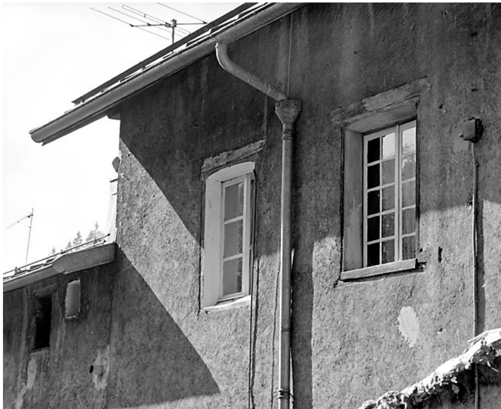
Façade postérieure : fenêtre du deuxième étage, à linteau en bois délardé en arc segmentaire. 39, Morez, 9 rue de la République
