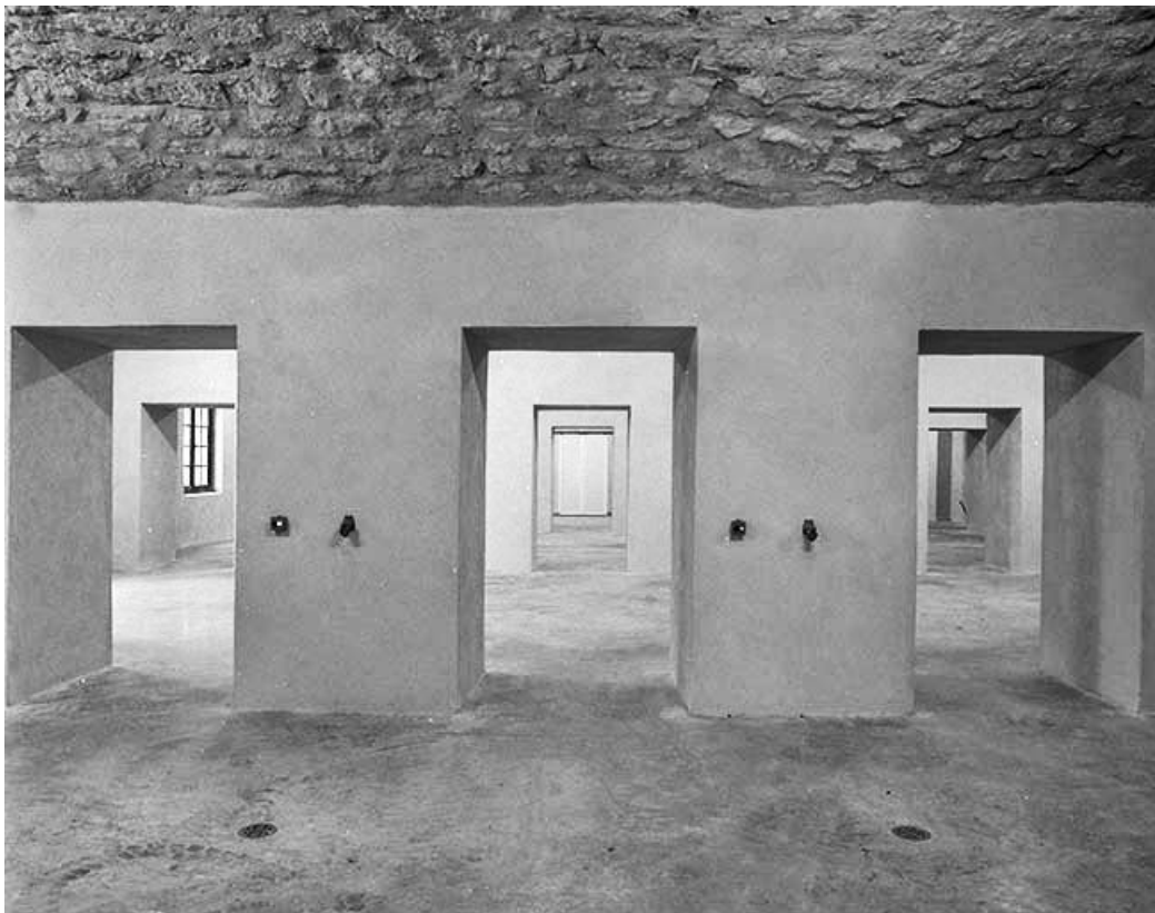
Bâtiment Quitry, pièces successives couvertes de voûtes en berceau segmentaire. 39, Les Rousses R.N. 5
