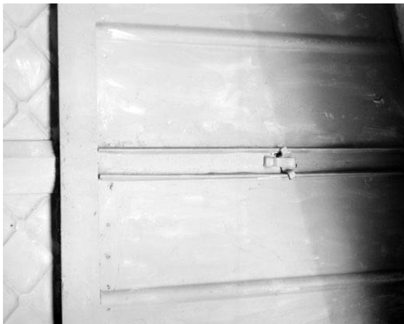
Système d'agrafage d'un panneau métallique (façade latérale droite).
