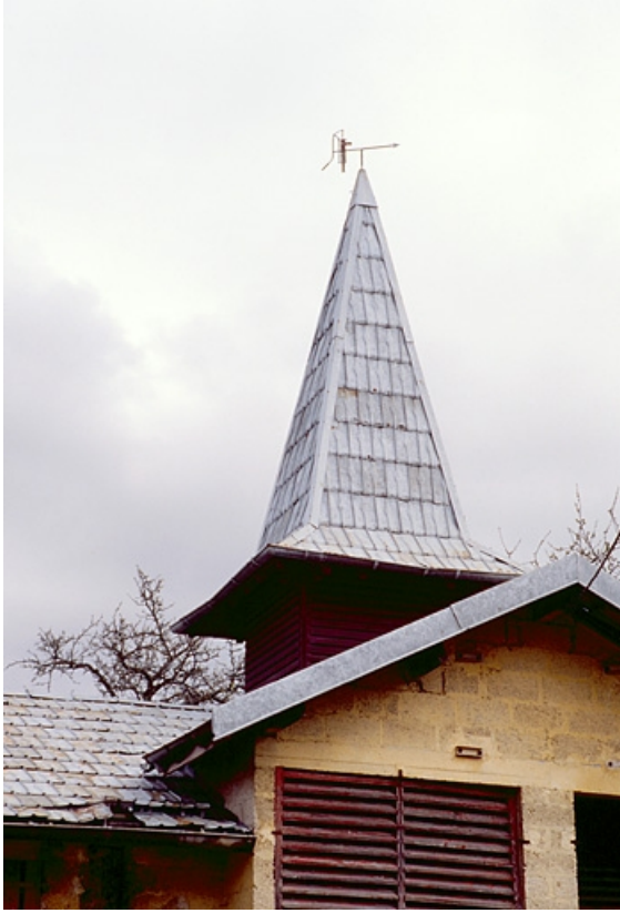
Remise d'automobile et bûcher (F) : flèche couverte de tuiles métalliques. 39, Saint-Amour rue des Enversys
