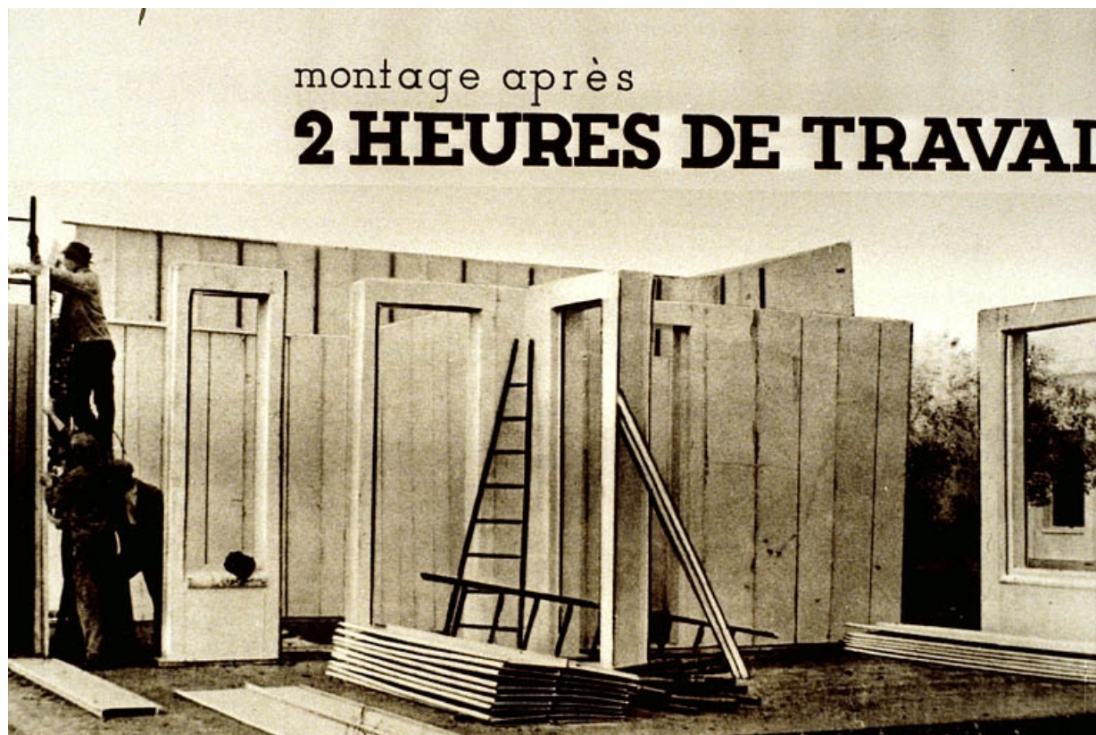
Montage d'une maison tout acier dans les années 1930 : mise en place des murs.
