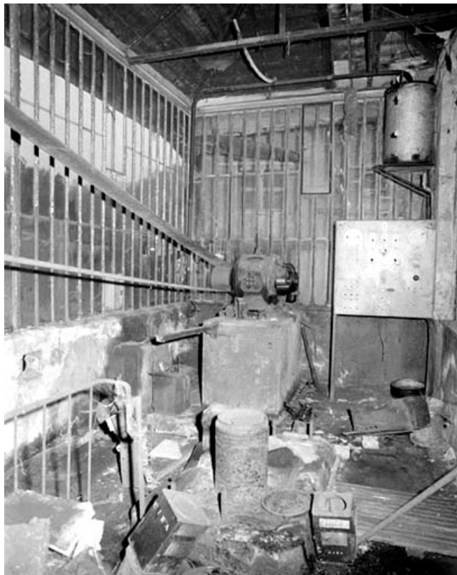
Moteur électrique Patay.
