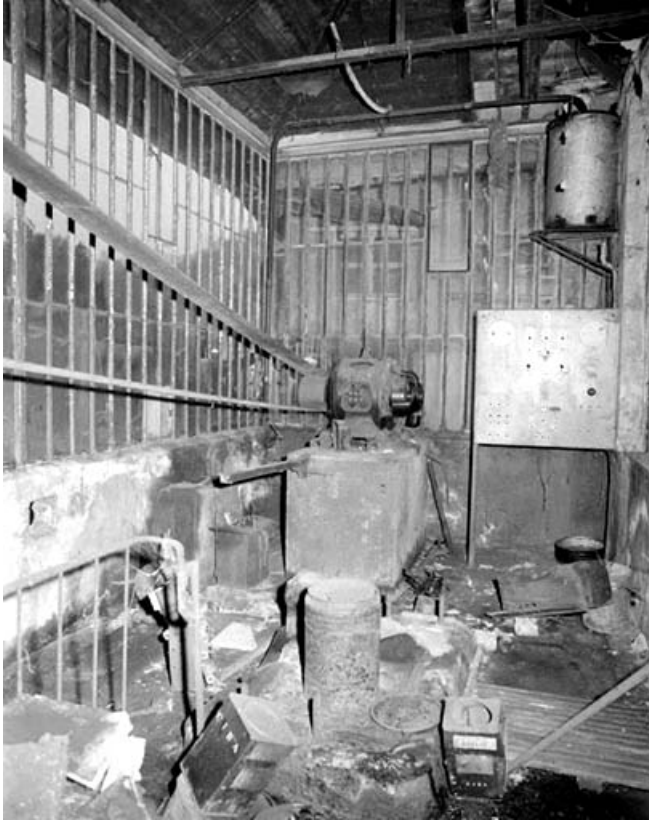
Moteur électrique Patay.
