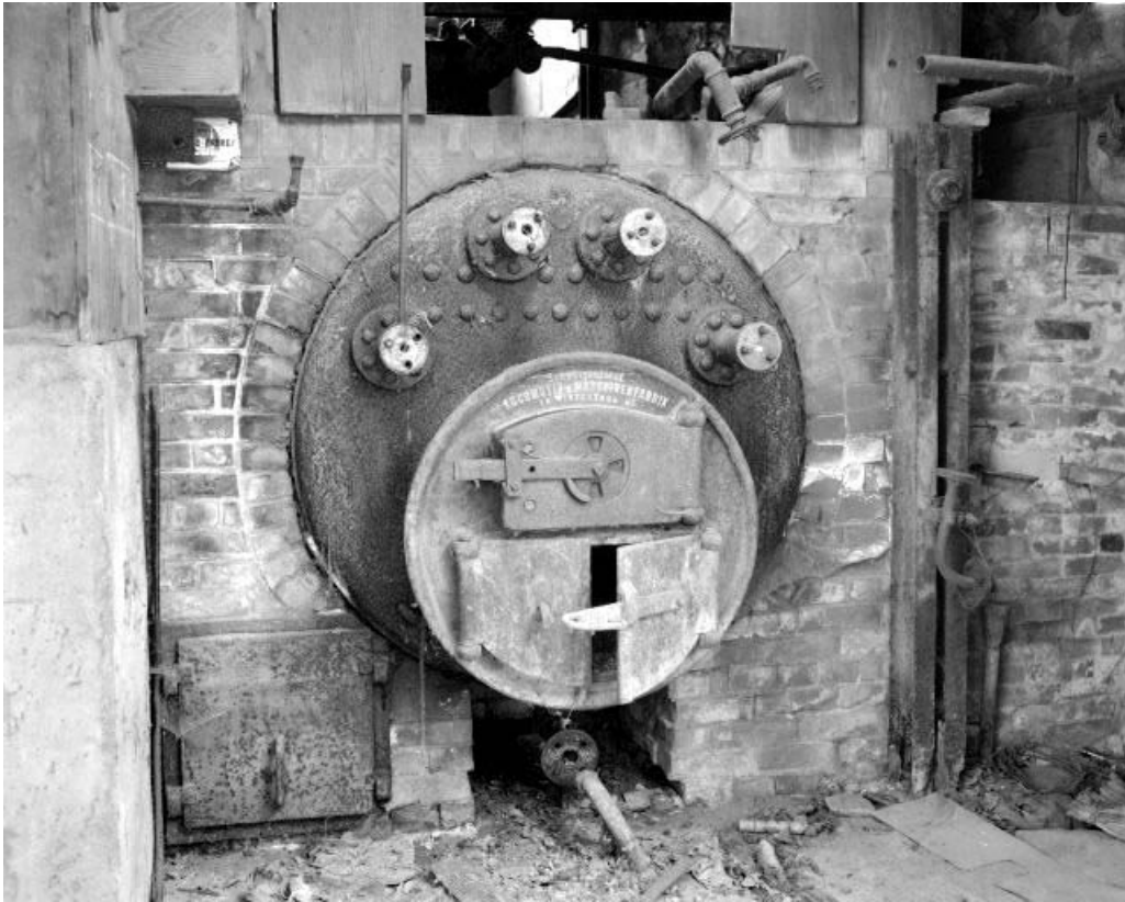
Intérieur de la chaufferie (Q) : chaudière. 39, Balanod, lieudit : sous Roches
