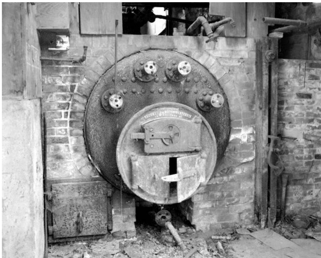
Intérieur de la chaufferie (Q) : chaudière.
