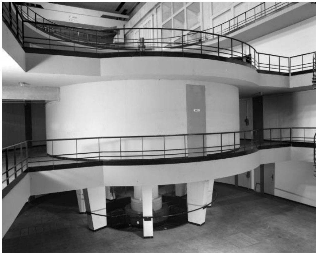
Intérieur de la centrale : pivoterie et alternateur du 2e groupe.
