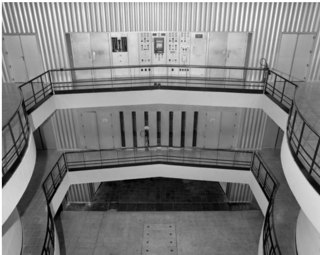
Intérieur de la centrale : vaisseau et panneau de commande.
