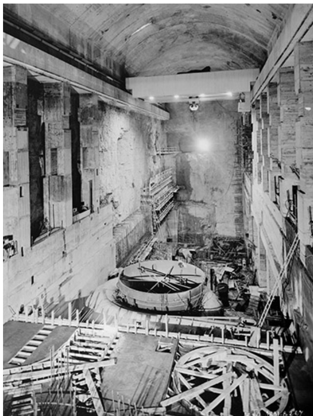
[Centrale. Vue intérieure et bache du groupe II ou III].
