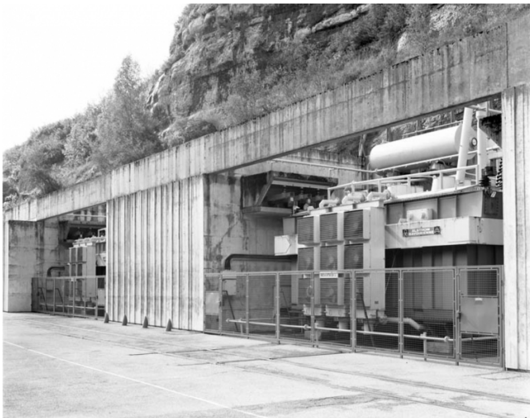
Vue d'ensemble des transformateurs.
