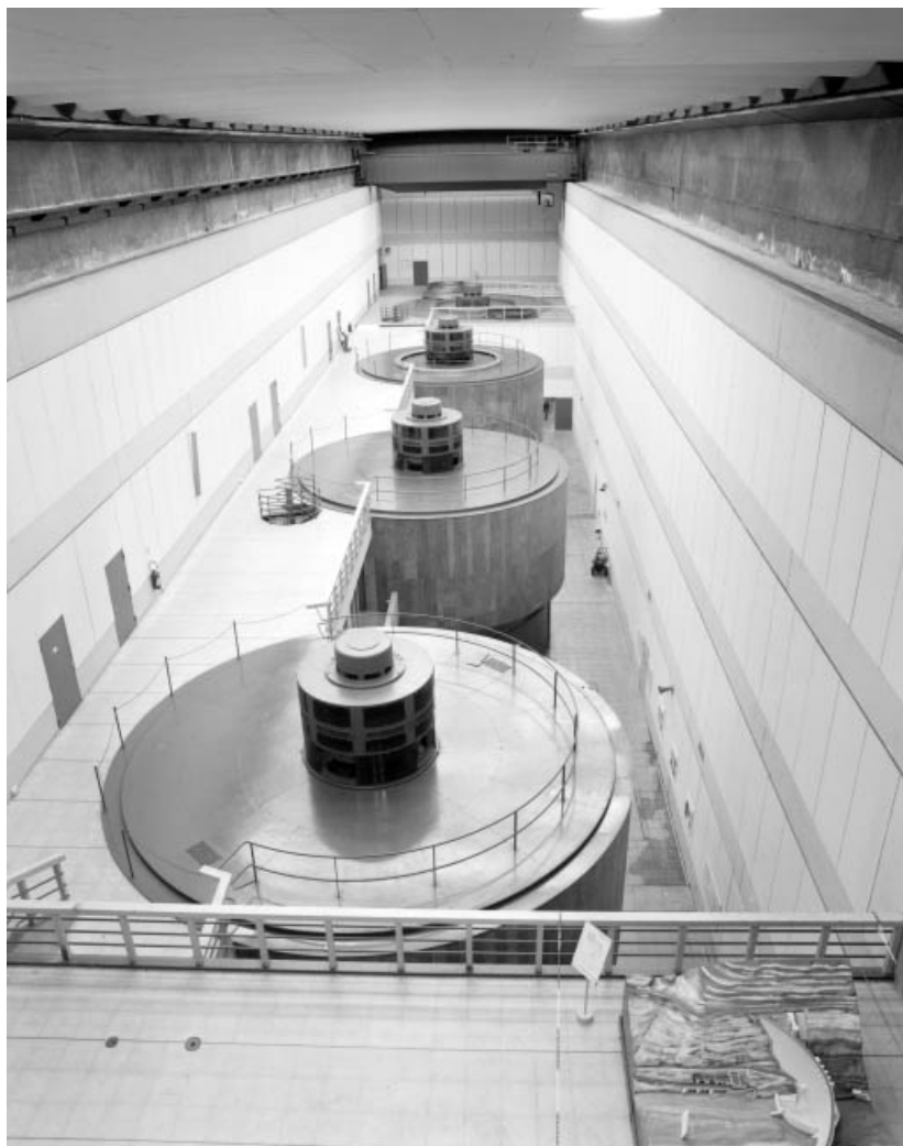
Vue d'ensemble de la salle des machines.
