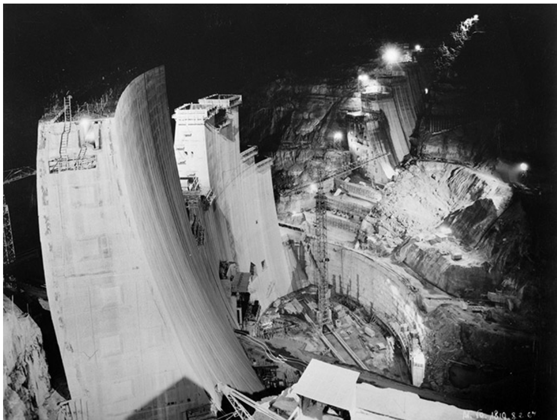
Barrage - Vue générale depuis R.D. aval des plots en cours de bétonnage (de nuit).
