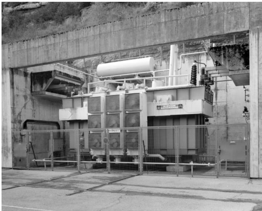
Transformateur Alstom de 160 MVA.
