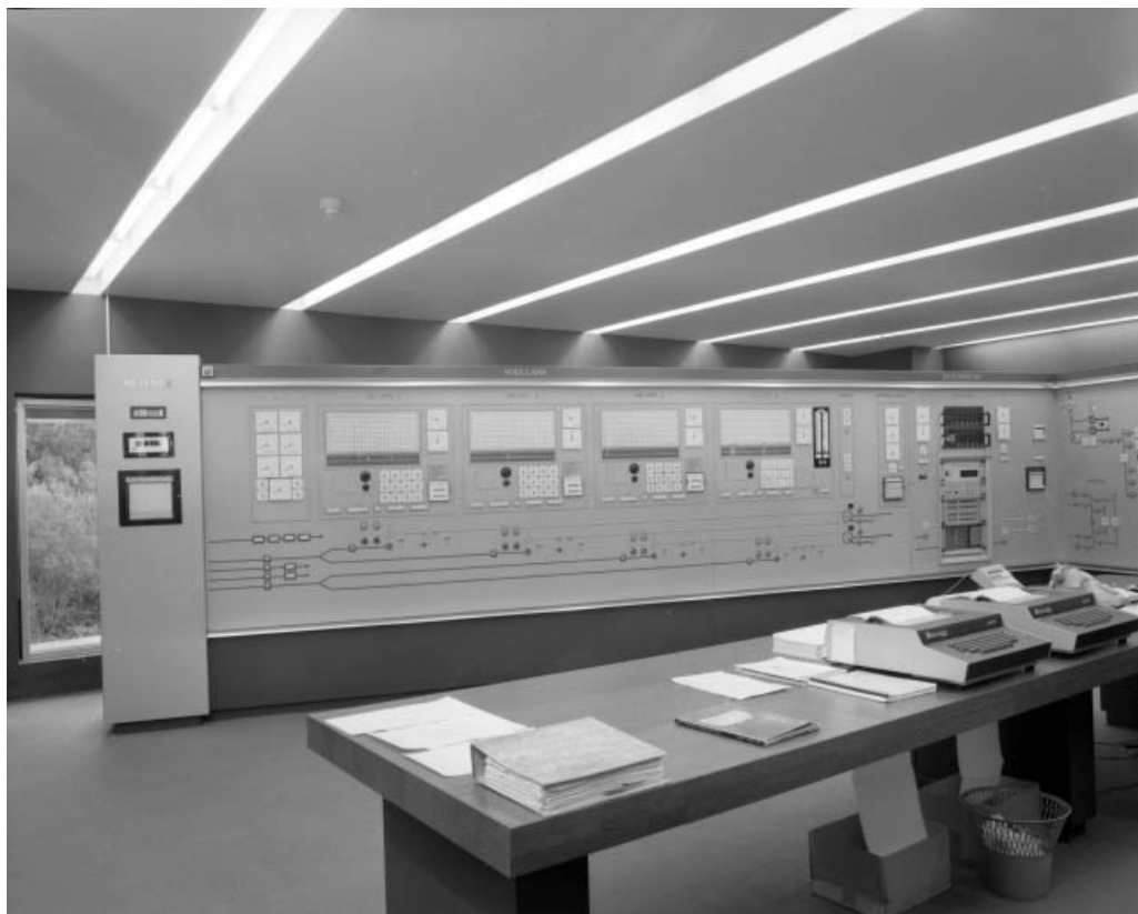
Vue d'ensemble de la salle de commande : tableau de contrôle.
