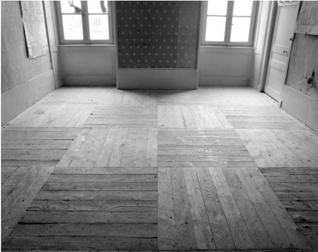
Intérieur de l'habitation : pièce en rez de chaussée à droite de l'escalier : détail du plancher.
