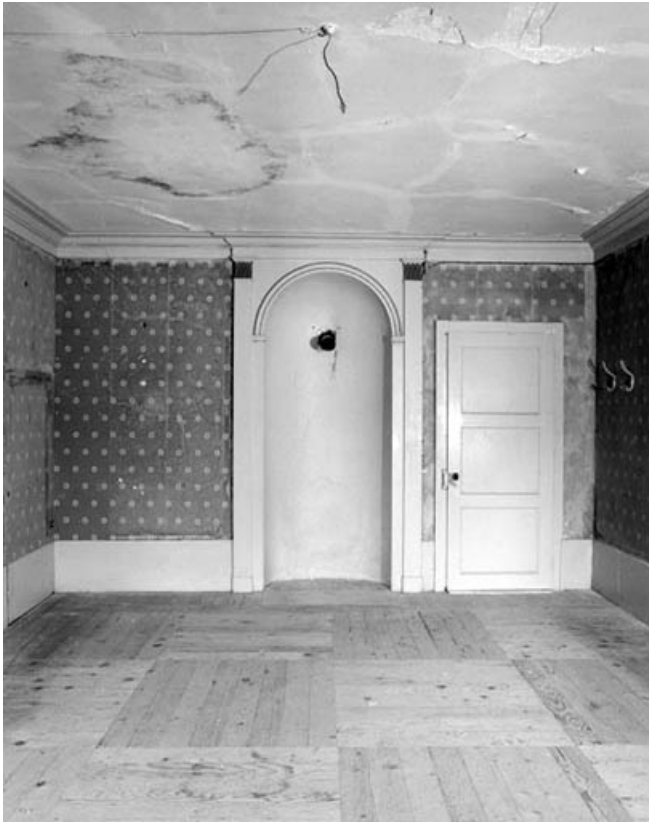
Intérieur de l'habitation : pièce en rez de chaussée, à droite de l'escalier principal, vue de la niche. 39, Syam 1ère demeure d'industriel, lieudit : les Forges
