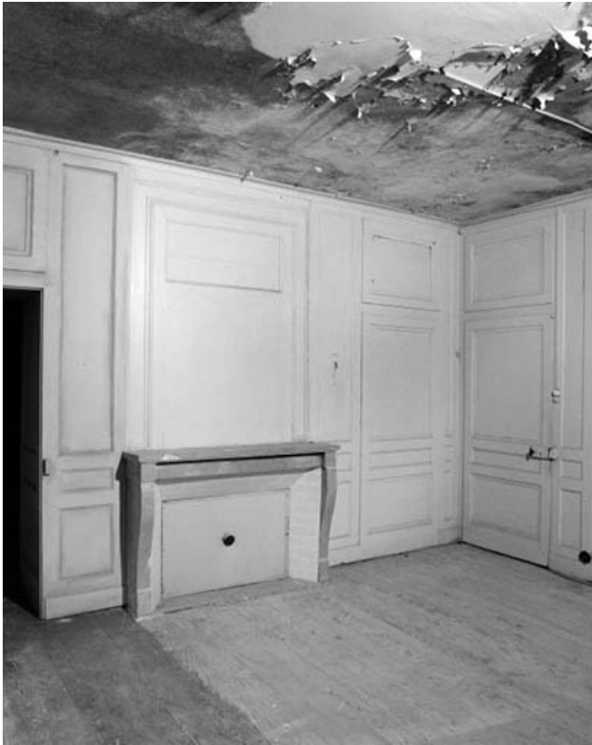
Intérieur de l'habitation : pièce en rez de chaussée, à l'angle sud-est de l'édifice. 39, Syam 1ère demeure d'industriel, lieudit : les Forges
