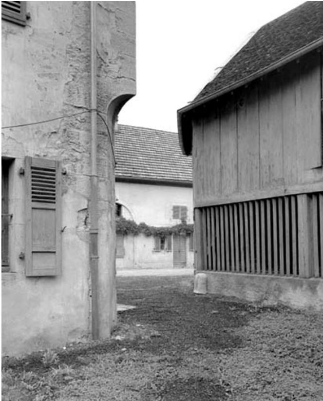
Façade postérieure de l'habitation : détail de l'angle droite, en face du bûcher. 39, Syam 1ère demeure d'industriel, lieudit : les Forges
