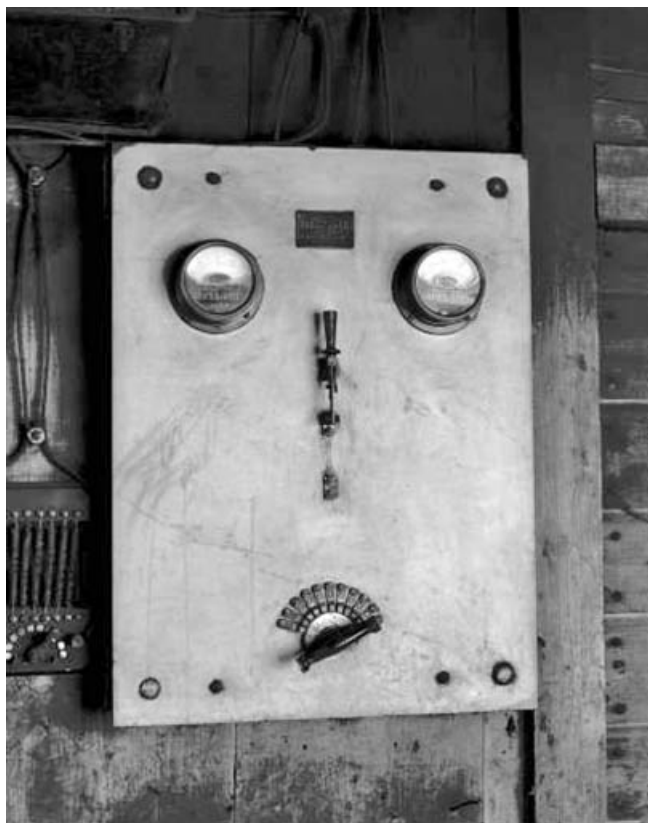
Intérieur : tableau de contrôle Grauer et Weil.
