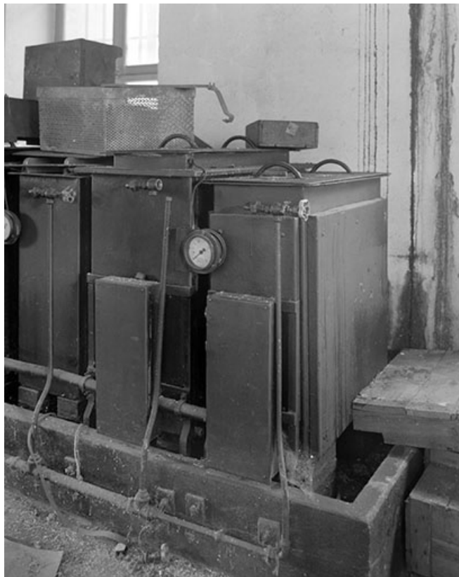
Atelier de fabrication (rez-de-chaussée) : détail de la chaîne d'électrolyse.
