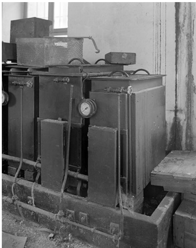
Atelier de fabrication (rez-de-chaussée) : détail de la chaîne d'électrolyse. 39, Saint-Claude, 1 rue du Tomachon
