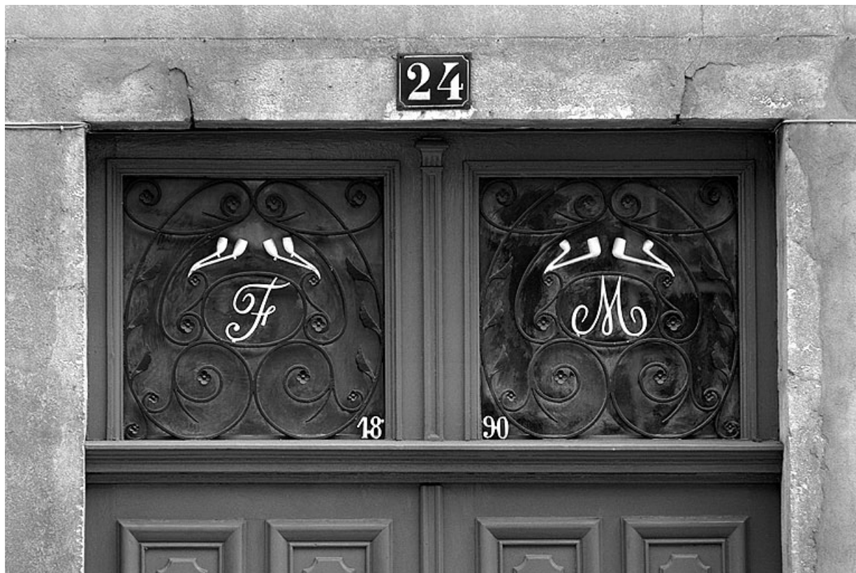
Pipes, initiales et date ornant le châssis de tympan de l'entrée du n° 24.
