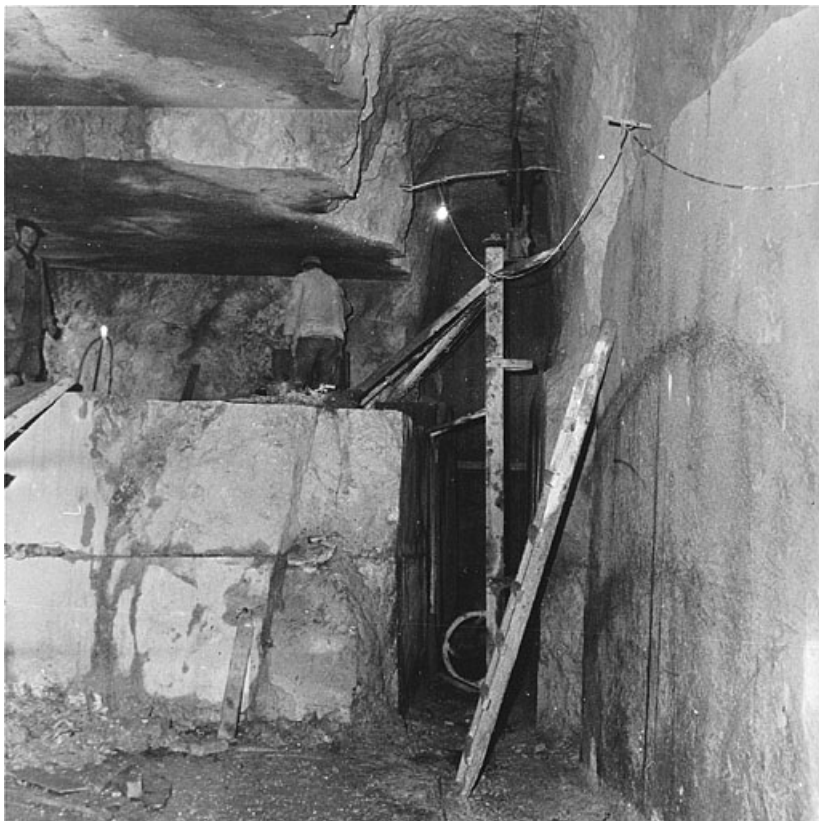
Intérieur de la carrière : fil hélicoïdal en place après dégagement des stériles. 39, Chassal, lieudit : à la Carrière
