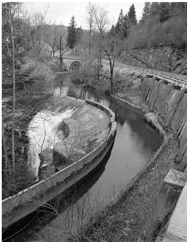
Canal d'amenée de la centrale.
