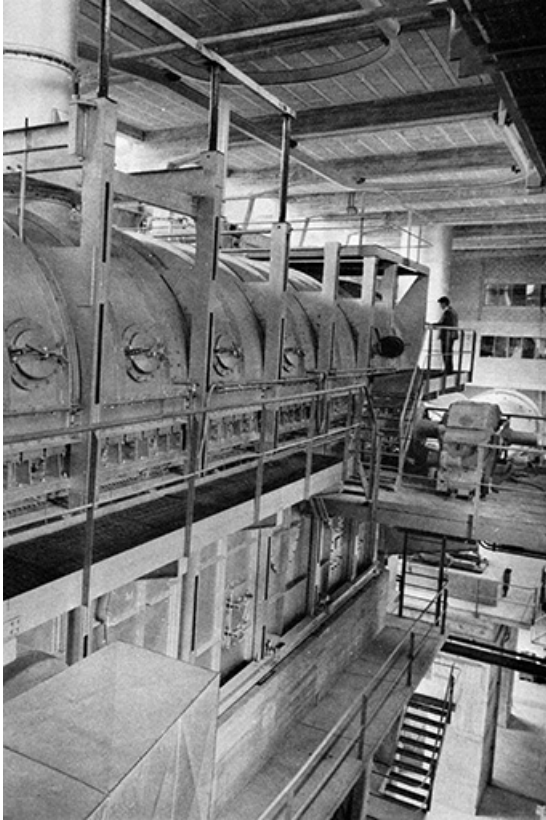
Four rotatif : zone de décarbonatation. 39, Champagnole chemin de Mont Rivel
