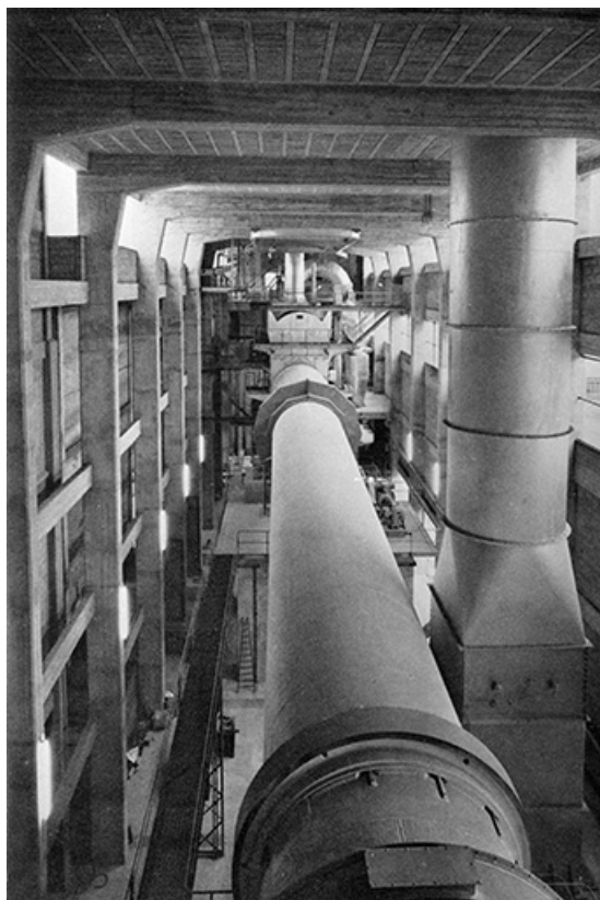
Vue d'ensemble du four rotatif.
