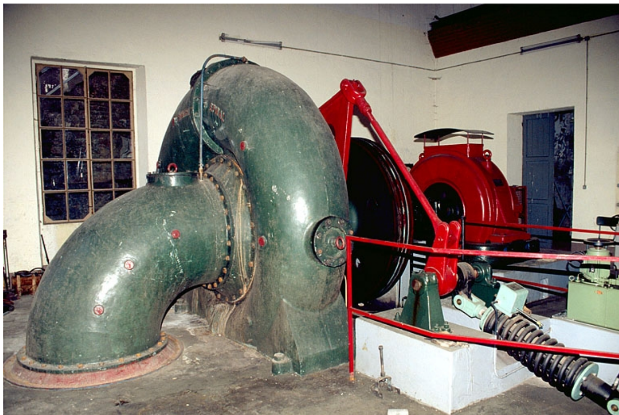
Vue rapprochée de la turbine n° 3.
