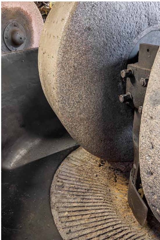
Défibreuse : détail des meules.
