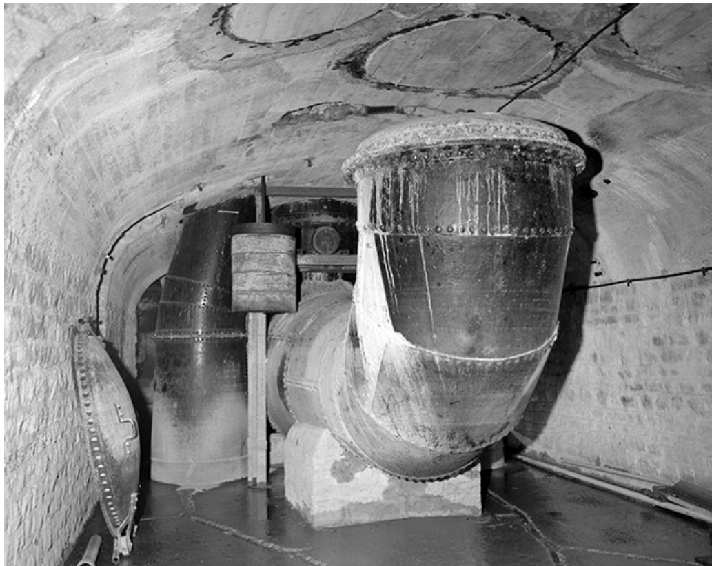
Intérieur de la centrale : collecteur en soubassement. Au premier plan, coude desservant autrefois le groupe de 1912. 03, Marigny V.C. 204
