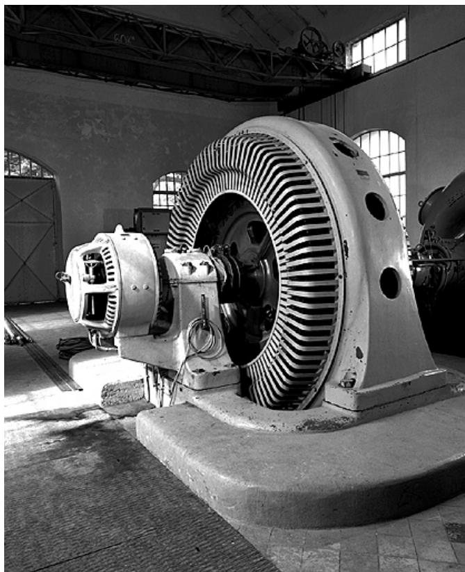
Intérieur de la centrale : alternateur de L'Eclairage Electrique. 39, Marigny V.C. 204
