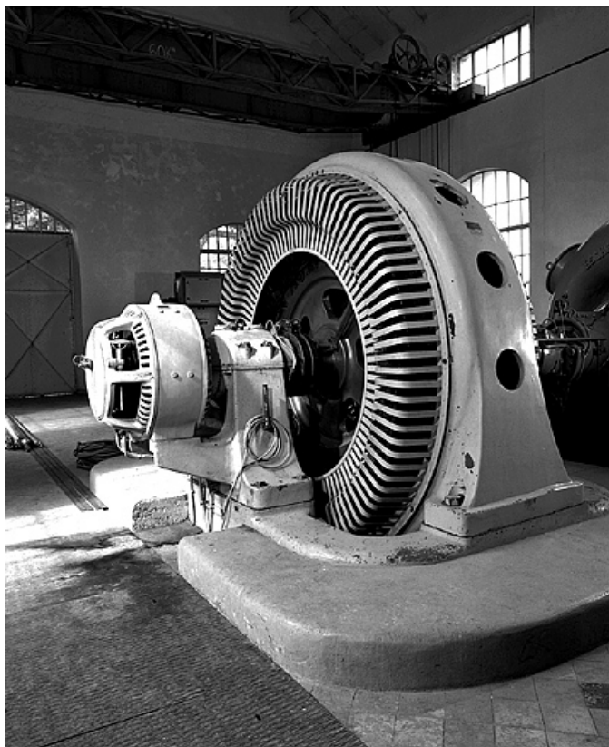
Intérieur de la centrale : alternateur de L'Eclairage Electrique. 03, Marigny V.C. 204
