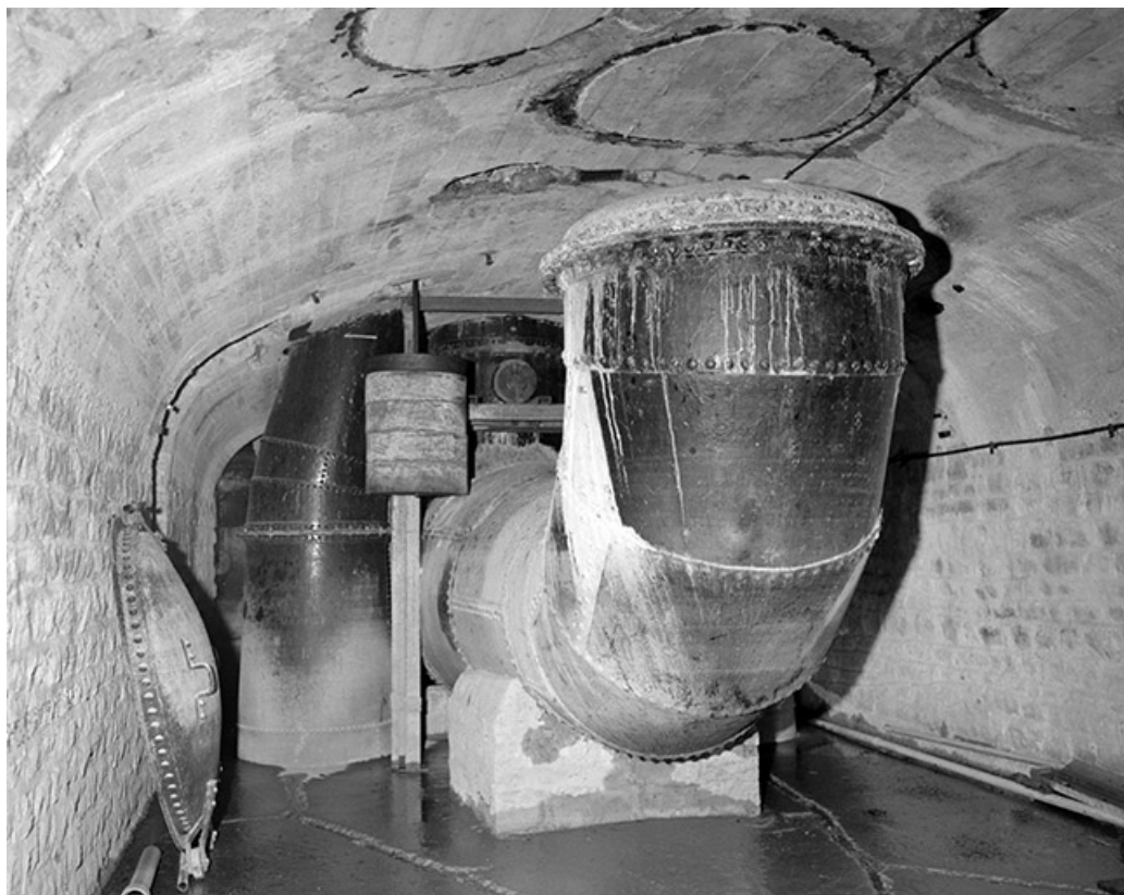
Intérieur de la centrale : collecteur en soubassement. Au premier plan, coude desservant autrefois le groupe de 1912. 39, Marigny V.C. 204
