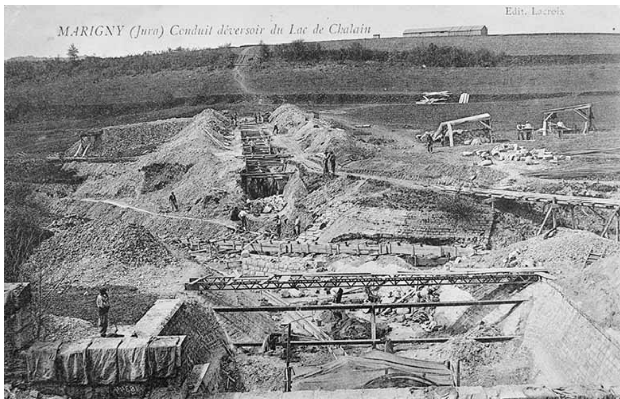
Marigny (Jura). Conduit déversoir du Lac de Chalain [le chantier vu depuis le haut de la conduite]. 03, Marigny V.C. 204
