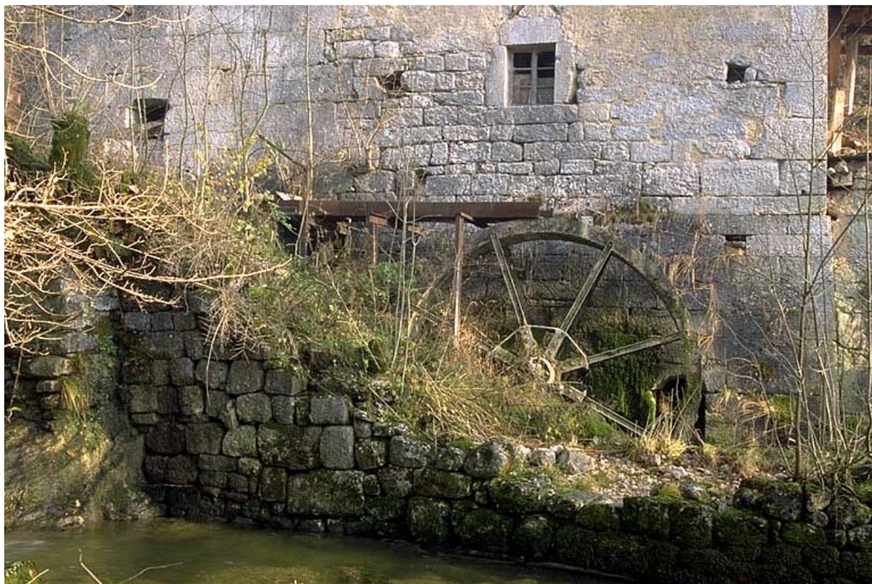
Roue hydraulique verticale aval.
