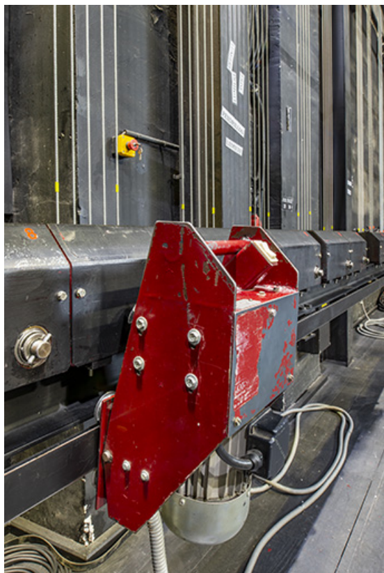
Salle, mur latéral nord-ouest, moteur permettant de faire descendre les cintres. 25, Besançon, 1 esplanade Jean-Luc Lagarce
