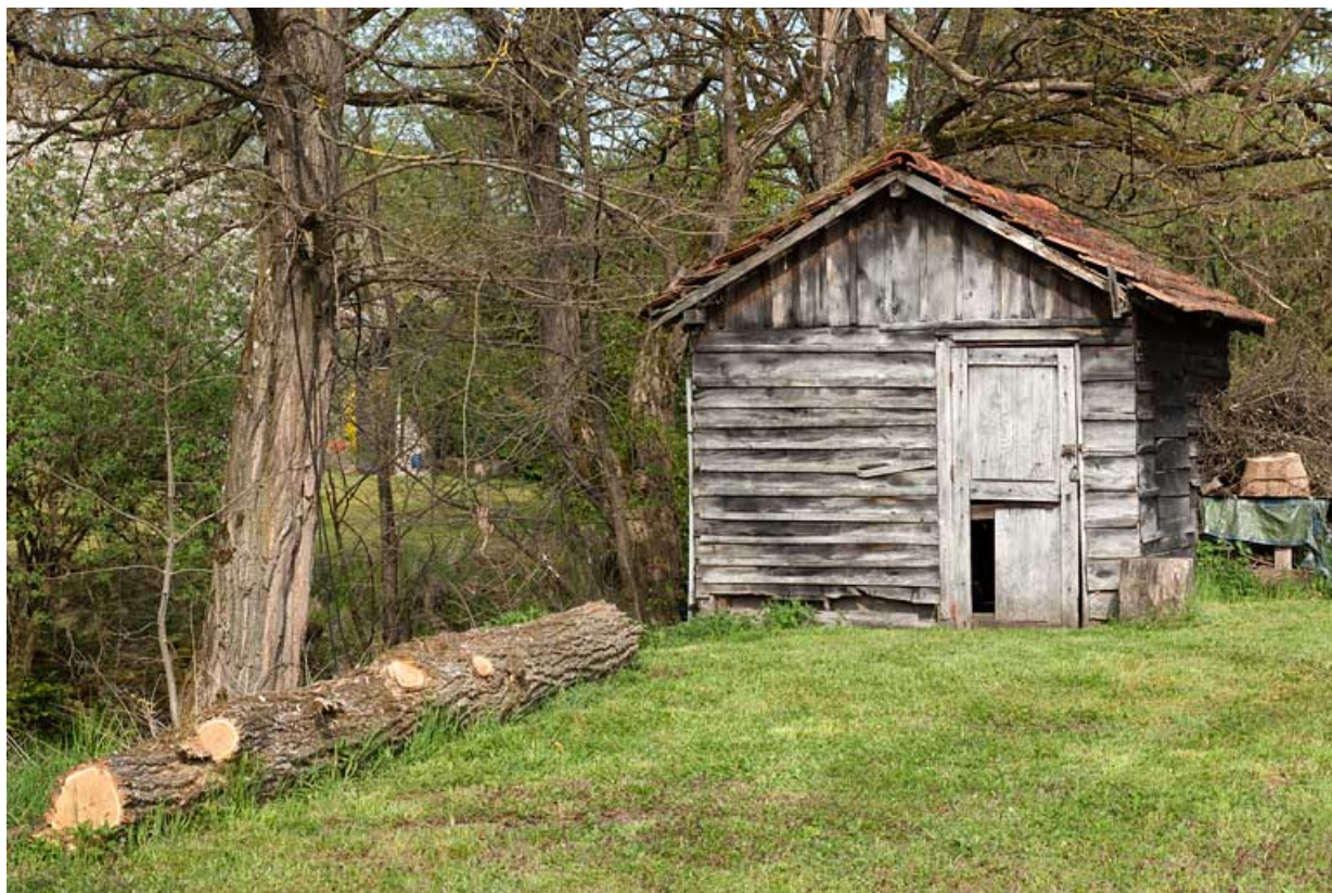
Scierie Courtot, rue du Pont : dépendance en pan de bois et essentage de planches. 25, Rougemont
