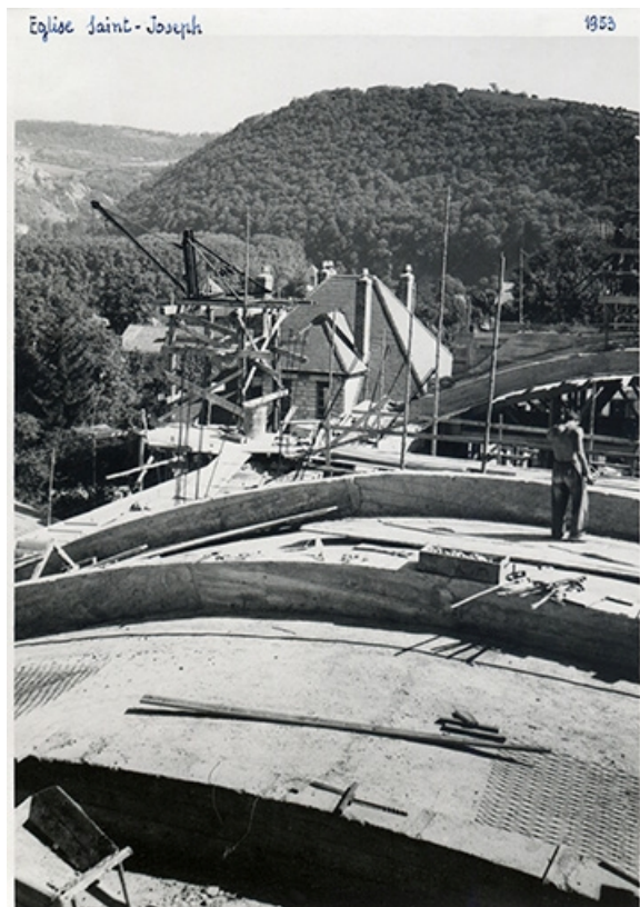
Chantier de l'église Saint-Joseph de Besançon : vue de la voûte en construction. 1953.
