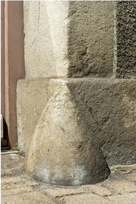
Immeuble 2 rue Jacques Courtois : chasse-roue.
