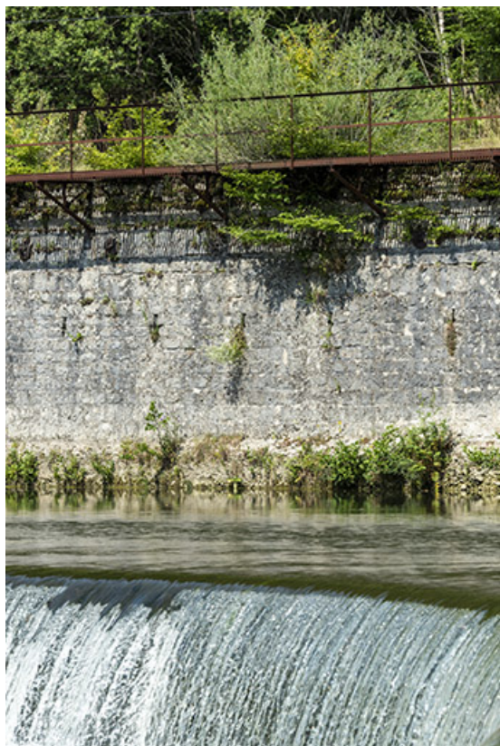
Canal d'amenée et ancien mur de soutènement de la voie ferrée et du parc aux fers.
