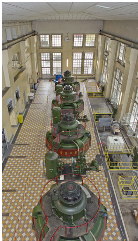
Centrale : vue plongeante sur la salle des machines.
