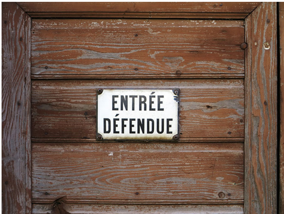
Bâtiment d'eau, façade antérieure : plaque émaillée sur la porte. 25, Liebvillers, 2-4 impasse du Moulin
