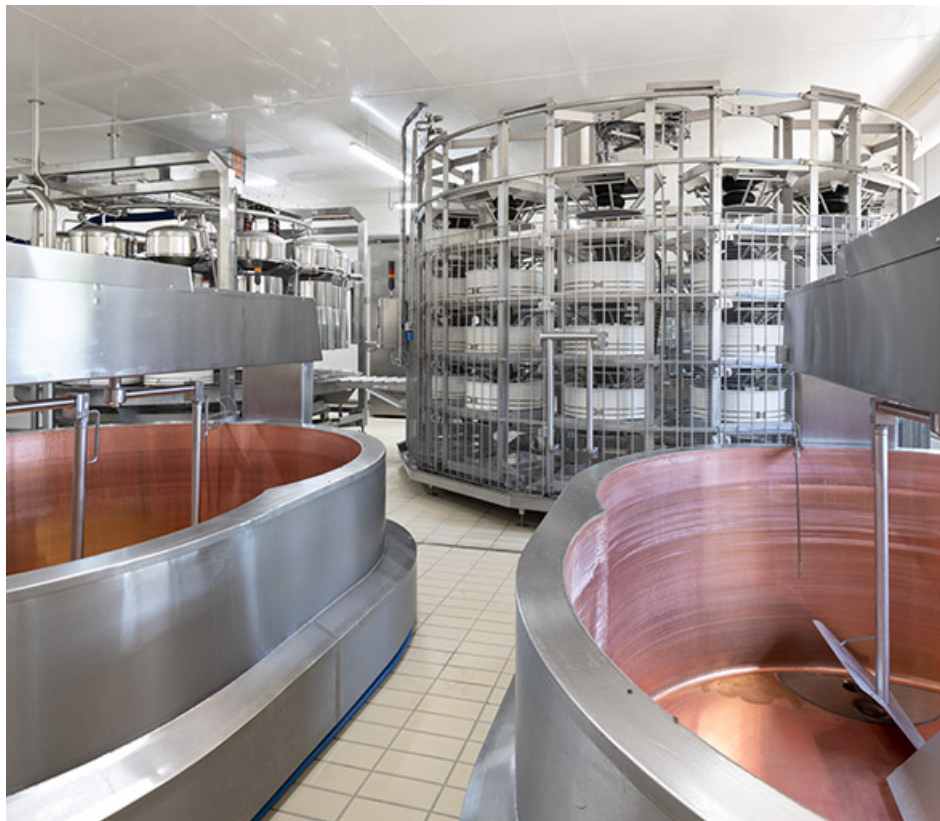
Installation de pressage, vue depuis les cuves.
