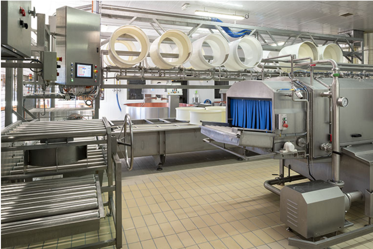
Atelier de fabrication : système de transfert des moules à gauche (avec le tableau de commande du pressage), extrémité du tunnel de lavage à droite.
