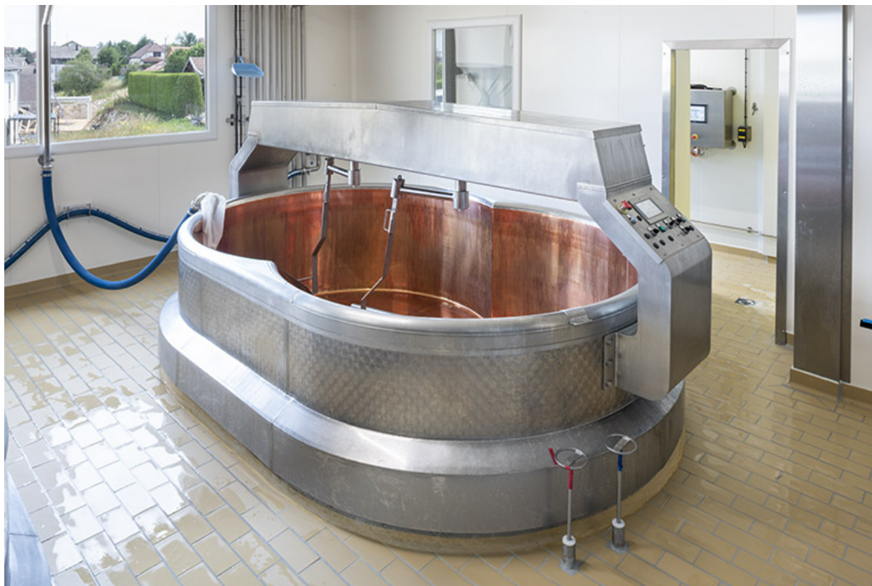
Atelier de fabrication : cuve est. 25, Le Russey, 13 rue Leclerc
