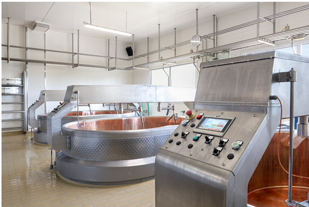
Atelier de fabrication : cuves. 25, Le Russey, 13 rue Leclerc
