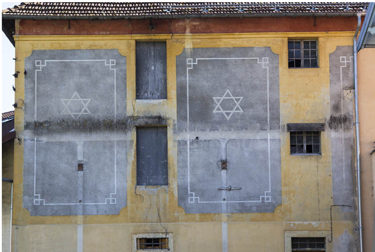
Entrepôt industriel, extrémité orientale : décor avec l'étoile de David. 25, Morteau, 1-4 rue de la Brasserie
