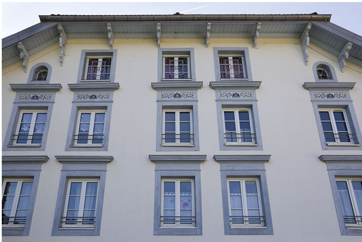
Premier atelier de fabrication, façade latérale gauche : fenêtres des étages, vues en contre-plongée. 25, Morteau, 1-4 rue de la Brasserie
