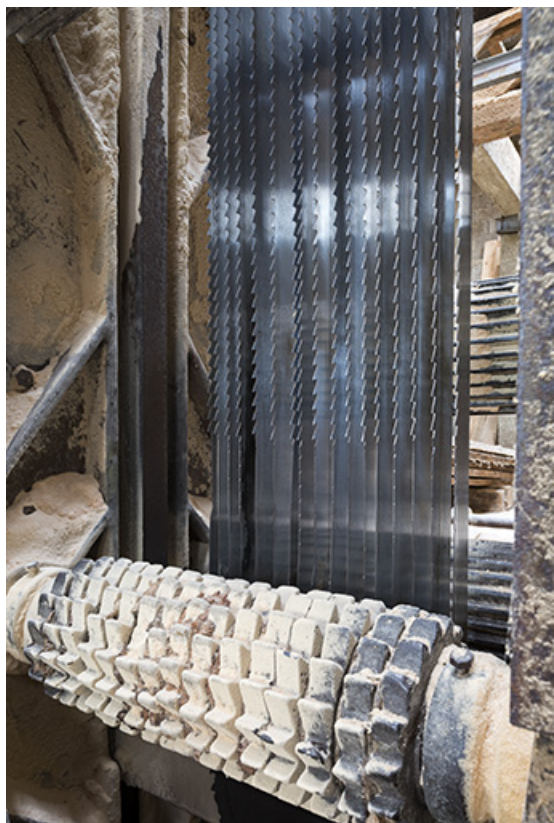
Atelier de fabrication : châssis de scie Socolest, rouleau et lames. 25, Montlebon, 13 rue du Moulin, lieudit : Cornabey
