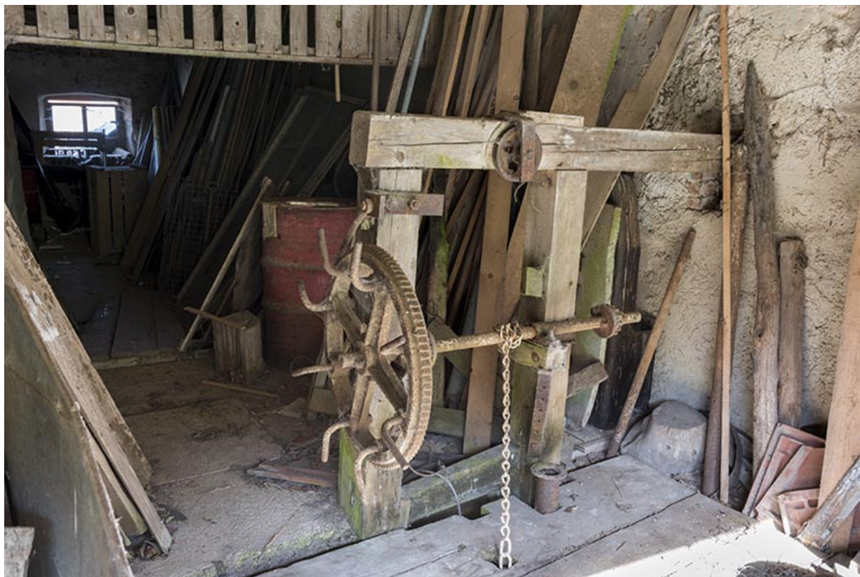
Bâtiment ancien, partie gauche (bâtiment d'eau) : commande de la vanne d'admission d'eau. 25, Montlebon, 13 rue du Moulin, lieudit : Cornabey
