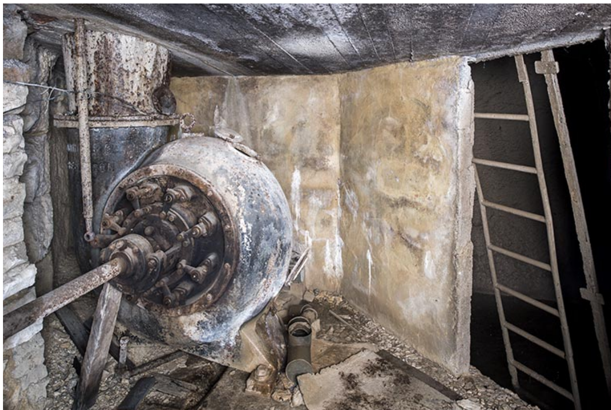
Atelier de fabrication, sciurier : turbine Dodge. La chambre d'eau est à gauche.
