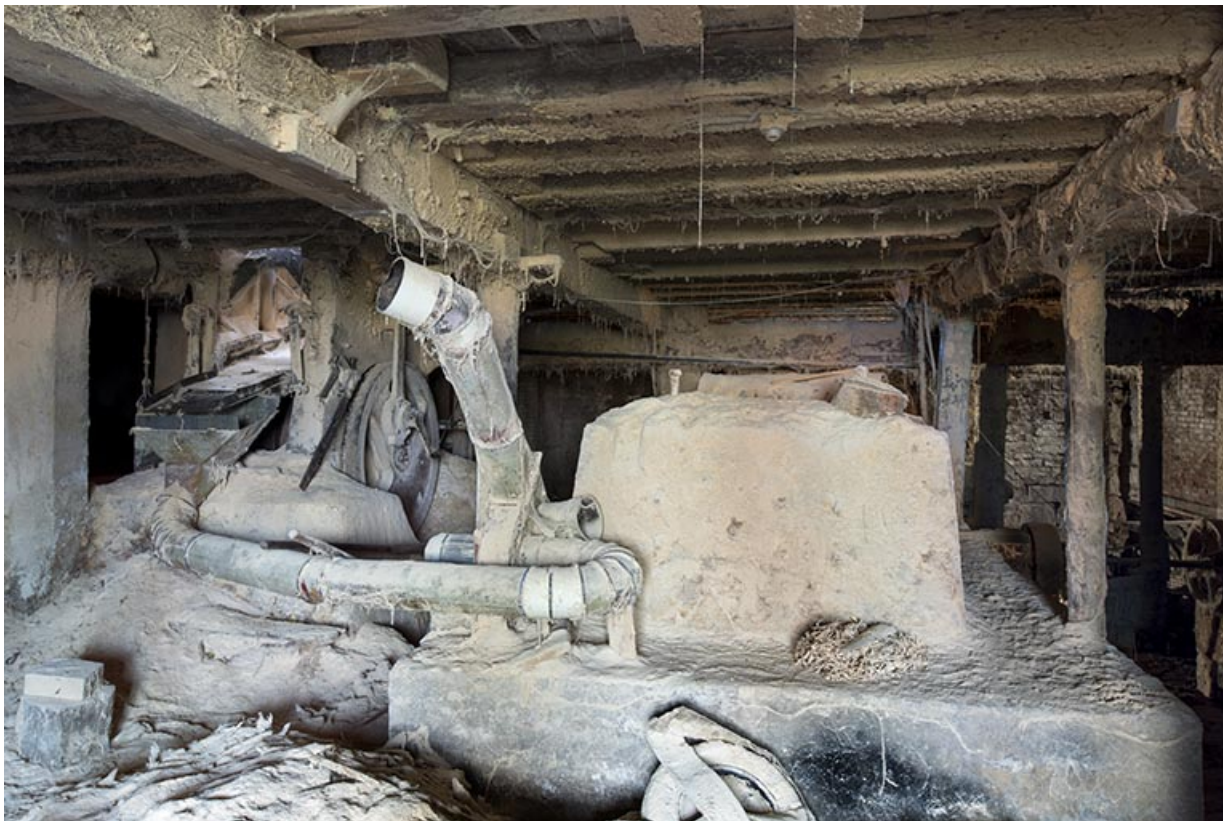
Atelier de fabrication, sciurier : massifs en maçonnerie de la scie Socolest (à gauche) et d'un châssis démonté. 25, Montlebon, 13 rue du Moulin, lieudit : Cornabey
